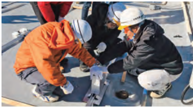
障害者とともに太陽光発電設備の設置。この事業には健康福祉局も参画した。
