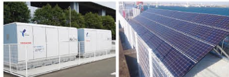
(左) 機器と貯蔵タンクがコンテナ2台に集約された自立型水素燃料電池システム。(右) 屋上には太陽光発電設備を設置
